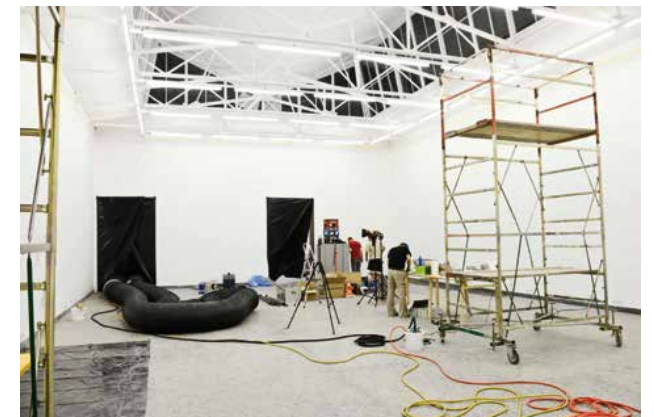
Der Pavillon in Venedig ist soweit vorbereitet: lichtdicht und klimatisiert
